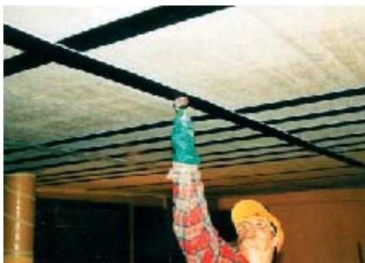
Vasbeton födém megerősítése Sika® CarboDur® lamellával (Sikadur-30 ragasztó és Sika® CarboDur® lamella)
